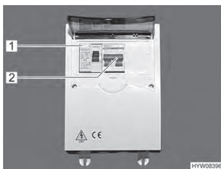
Bilde 116 230 V-sikringsboks med ledningsbeskyttelsesbryter og FI-bryter
