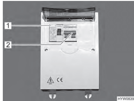
Bilde 104 230 V-sikringsboks med ledningsbeskyttelsesbryter og FI-bryter
