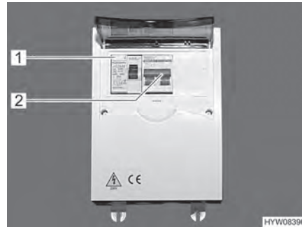
Kuva 104 230 V:n sulakerasia ja johdinsuojakytkin sekä FI-kytkin
