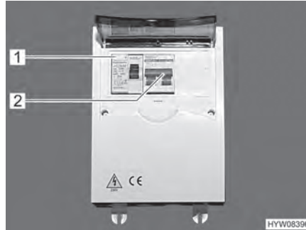
Afb. 104 230-V-zekeringenkast met beveiligingsautomaat en FI-schakelaar
