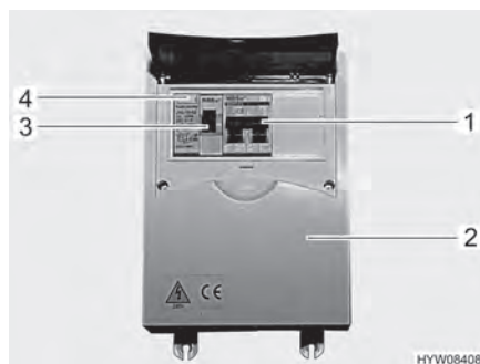
Afb. 98 230-V-zekeringenkast met beveiligingsautomaat en FI-schakelaar
