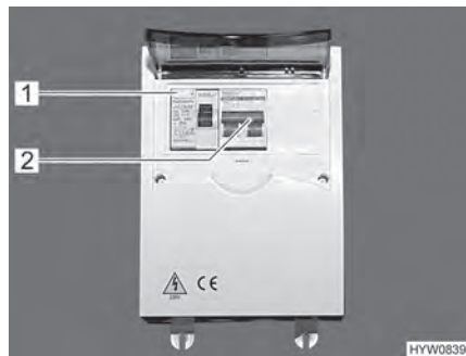
Afb. 109 230-V-zekeringenkast met beveiligingsautomaat en FI-schakelaar
