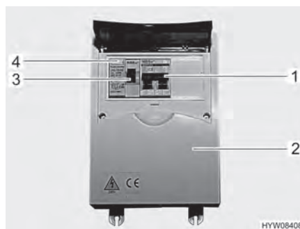
Afb. 97 230-V-zekeringenkast met beveiligingsautomaat en FI-schakelaar
