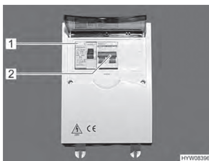
Bild 109 230 V-säkringslåda med ledningsskyddsbrytare och FI-brytare
