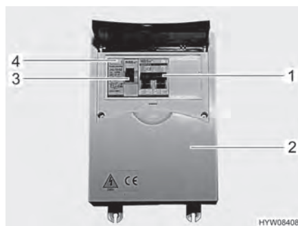
Bild 97 230 V-säkringslåda med ledningsskyddsbrytare och FI-brytare
