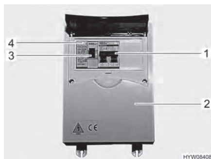
Fig. 97 Caja de fusibles de 230 V con interruptor de protección de línea e interruptor FI
