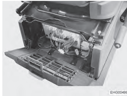
Fig. 94 Lugar de instalación del bloque eléctrico
