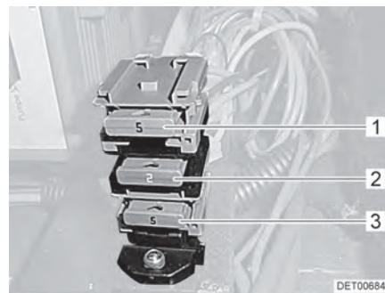
Fig. 104 Fusibles junto al bloque eléctrico
