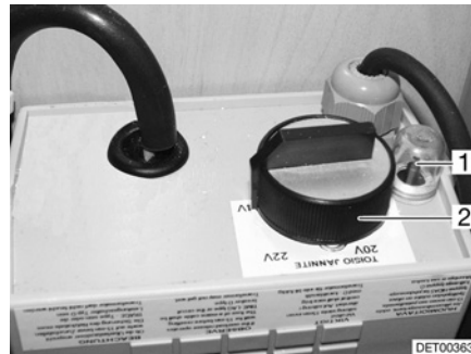
Bilde 89 Bryter for elektrisk gulvvarme
