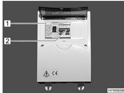
Bilde 79 230 V-sikringsboks med ledningsbeskyttelsesbryter og FI-bryter
