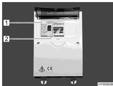
Afb. 109 230-V-zekeringenkast met beveiligingsautomaat en FI-schakelaar
