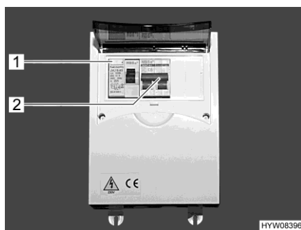
Bild 109 230 V-säkringslåda med ledningsskyddsbrytare och FI-brytare
