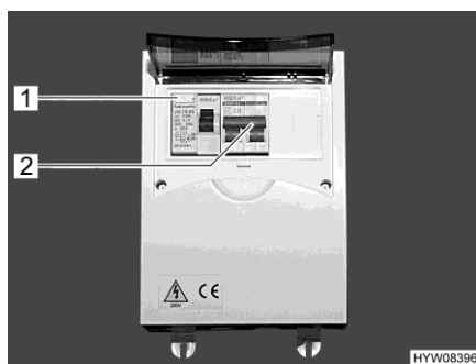
Bilde 109 230 V-sikringsboks med ledningsbeskyttelsesbryter og FI-bryter
