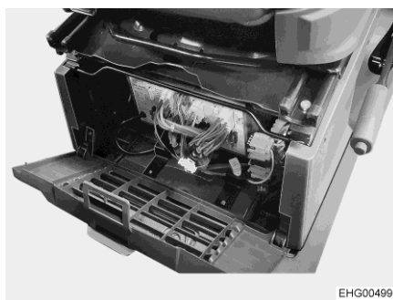
Fig. 71 Lugar de instalación del bloque eléctrico
