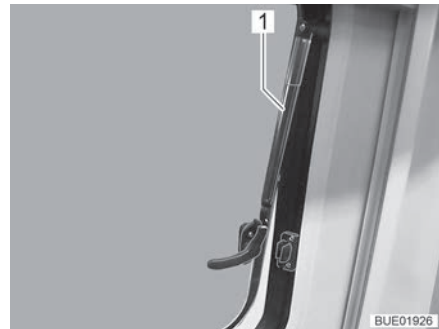
Bild 13 Överkantshängt fönster med automatik-spärrar, öppet
