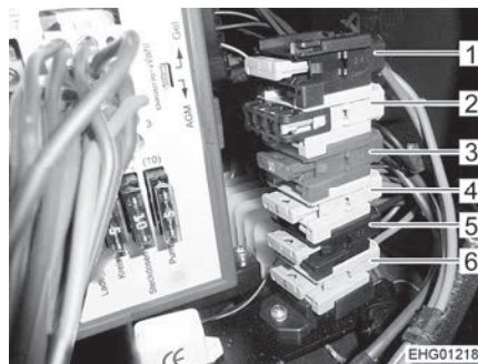
Fig. 164 Fusibili accanto alla centralina elettrica
