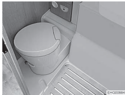
Bild 205 Toalettstol, vriden mot väggen
