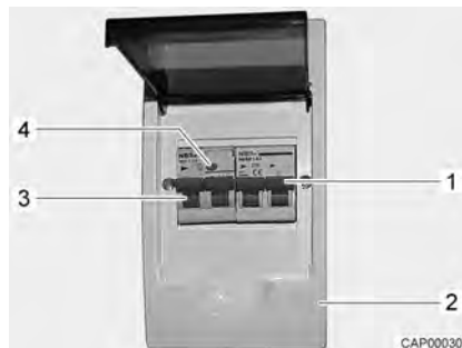
Bild 56 Ledningsskyddsbrytare och FI-brytare (230 V-säkringslåda)
