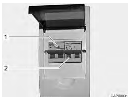
Bild 61 230 V-säkringslåda med ledningsskyddsbrytare och FI-brytare
