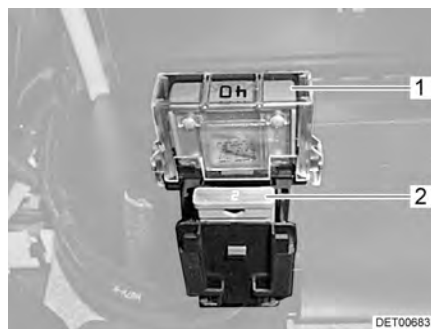
Fig. 60 Fusibles de la batterie de cellule
