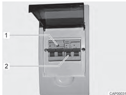
Afb. 61 230-V-zekeringenkast met beveiligingsautomaat en FI-schakelaar
