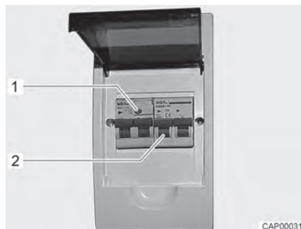
Kuva 61 230 V:n sulakerasia ja johdinsuojakytin sekä FI-kytkin
