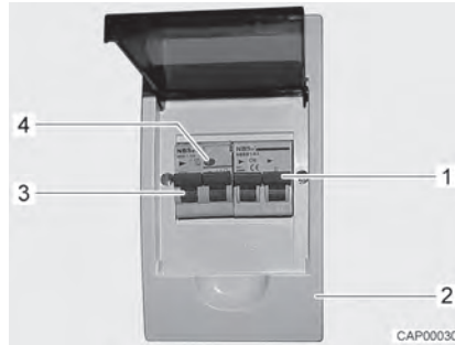
Kuva 56 Johdinsuojakytkimet ja FI-kytkin (230 V:n sulakerasia)
