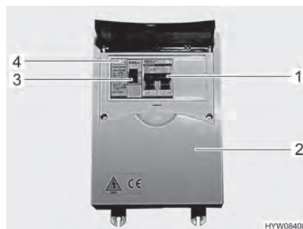
Bild 98 230 V-säkringslåda med ledningsskyddsbrytare och FI-brytare
