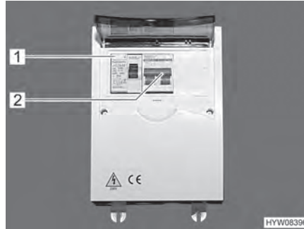
Bild 104 230 V-säkringslåda med ledningsskyddsbrytare och FI-brytare
