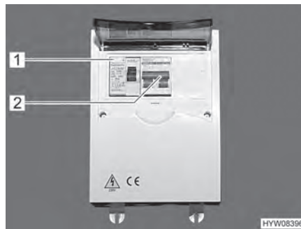
Bilde 109 230 V-sikringsboks med ledningsbeskyttelsesbryter og FI-bryter
