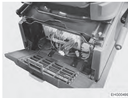
Bilde 94 Monteringssted for strømsentralen
