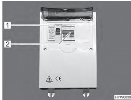
Kuva 109 230 V:n sulakerasia ja johdinsuojakytkin sekä FI-kytkin
