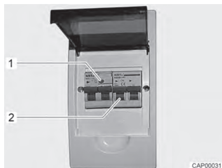
Bilde 90 230 V-sikringsboks med ledningsbeskyttelsesbryter og FI-bryter
