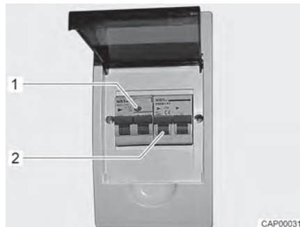
Bilde 61 230 V-sikringsboks med ledningsbeskyttelsesbryter og FI-bryter
