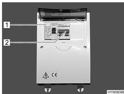
Bild 76 230 V-säkringslåda med ledningsskyddsbrytare och FI-brytare
