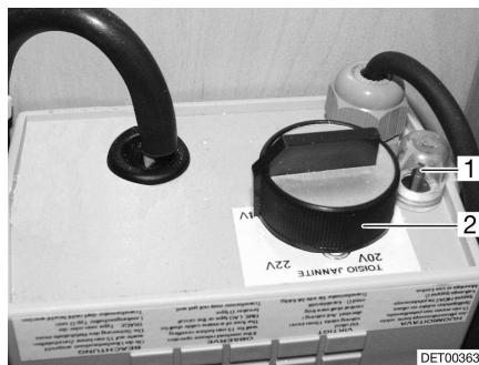
Bild 86 Reglage för elektrisk golvvärme
