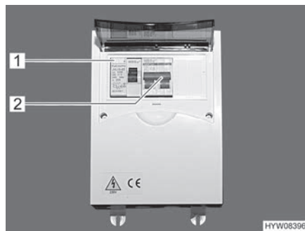
Bilde 88 230 V-sikringsboks med ledningsbeskyttelsesbryter og FI-bryter
