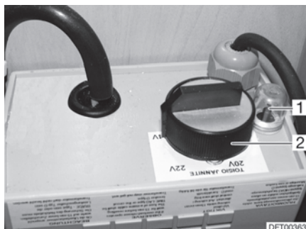
Bilde 98 Bryter for elektrisk gulvvarme
