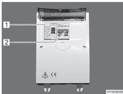
Bild 88 230 V-säkringslåda med ledningsskyddsbrytare och FI-brytare
