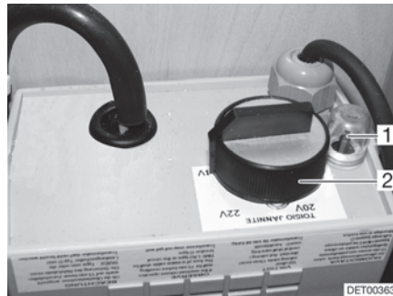
Afb. 98 Regelaar voor de elektrische vloerverwarming
