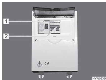
Afb. 88 230-V-zekeringenkast met beveiligingsautomaat en FI-schakelaar
