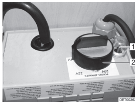
Kuva 98 Sähköisen lattialämmityksen säädin
