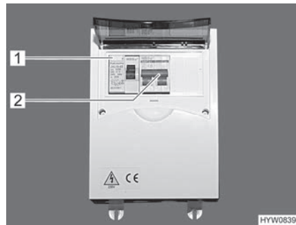
Kuva 88 230 V:n sulakerasia ja johdinsuojakytkin sekä FI-kytkin
