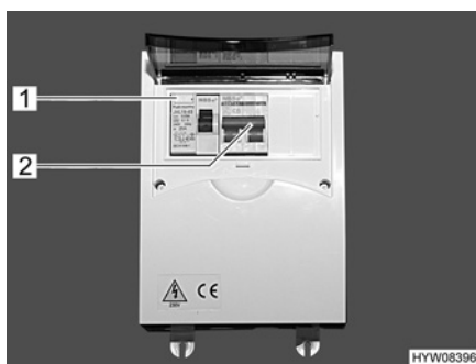
Afb. 79 230-V-zekeringenkast met beveiligingsautomaat en FI-schakelaar
