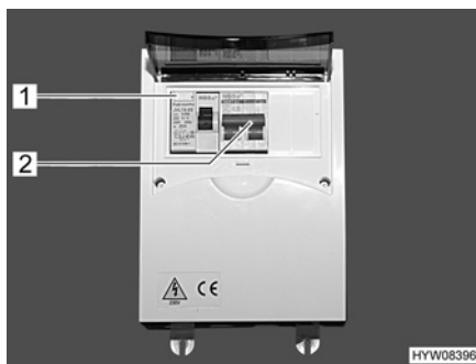
Bild 79 230 V-säkringslåda med ledningsskyddsbrytare och FI-brytare
