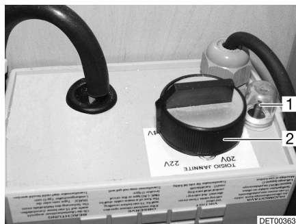
Bilde 86 Bryter for elektrisk gulvvarme
