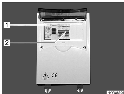
Kuva 76 230 V:n sulakerasia ja johdinsuojakytkin sekä FI-kytkin
